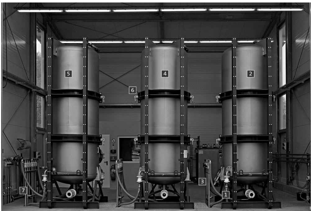
Рис. 7. Система очищення ґрунтових вод на майданчику Хуго 2/5/8 в Гельзенкірхені. Енергозабезпечення за рахунок фотовольтаніки на даху [3]
