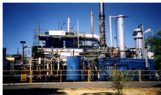
Рис. 2. Загальний вигляд комплексу для ГФХР обробки забрудненого ґрунту
